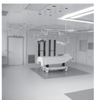
Schulthesklinik Operationssaal mit höchstem Schutzgrad nach den neuesten Richtlinien, Zürich
